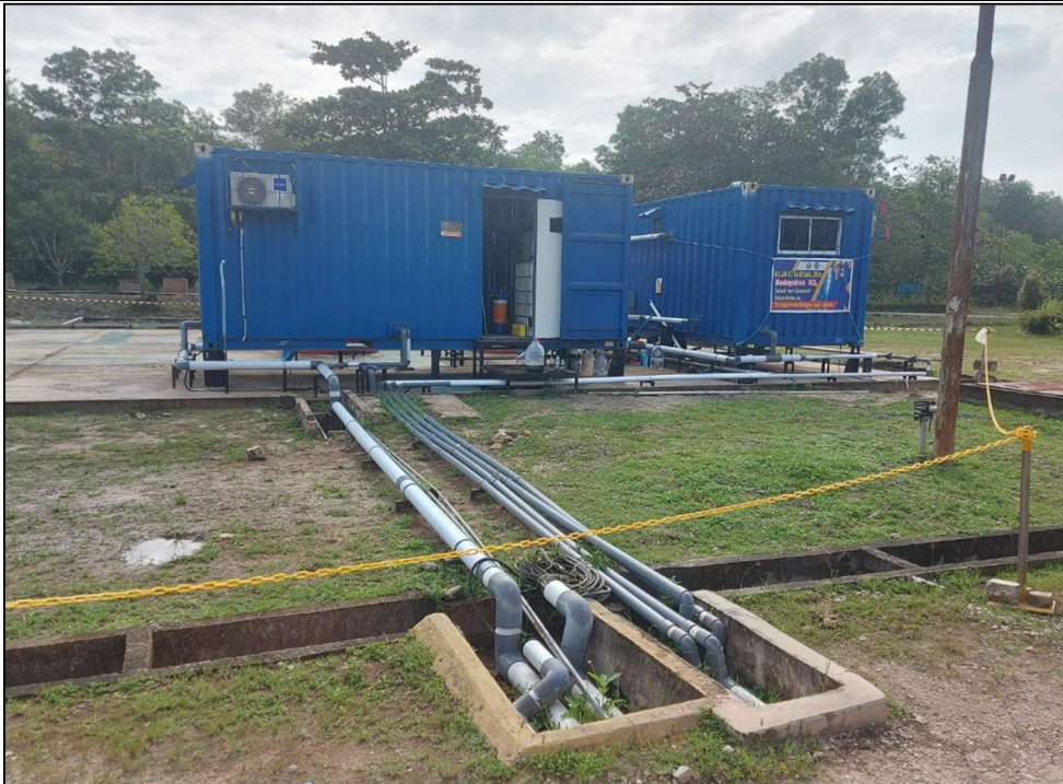
Fasilitas WWTP Elektrokoagulasi Container 1 dan 2
