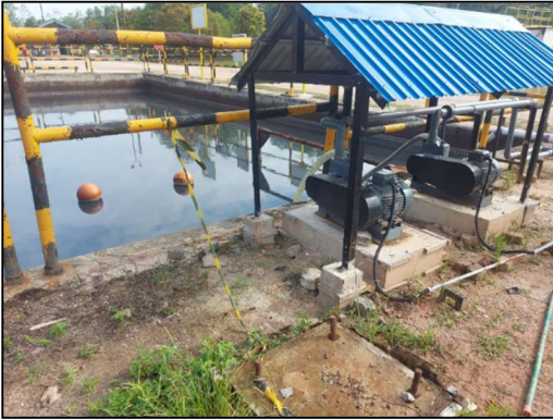
Waste Pond dan Pompa Intake
